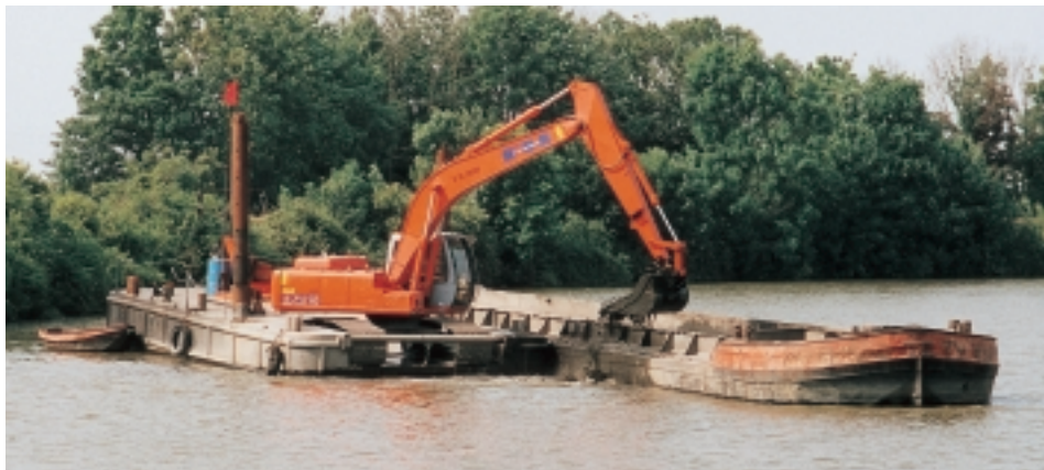
In de kleinere havens nemen baggeraars hun toevlucht tot grijpkranen die vanop pontons opereren en de specie in klepbakken dumpen. Hier een analoge werkwijze gedemonstreerd op de Uzer (WWK)
