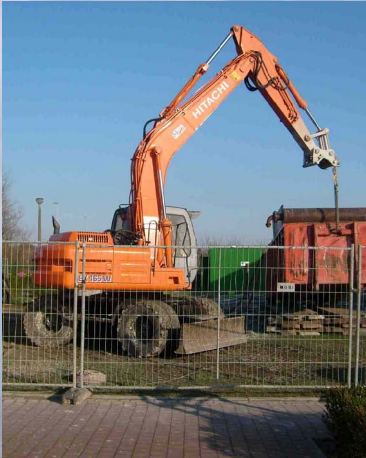
Kraan en spoelwatercontainers
