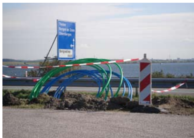
Glasvezelverbindingen transporteren beelden naar de verkeerscentrales
