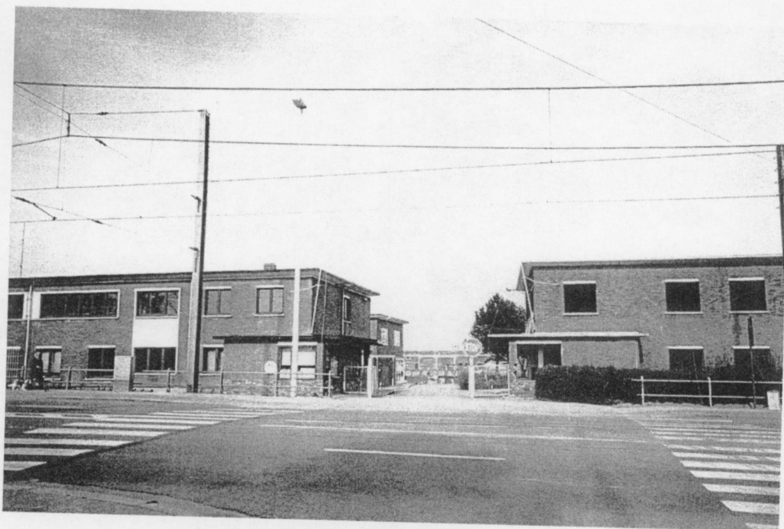
Fig. nrs. 116 en 117. Haven Oostende, 1998. De sloop van de gebouwen van het Mijnveegcentrum aan de Slijkenssteenweg is aangevat.
