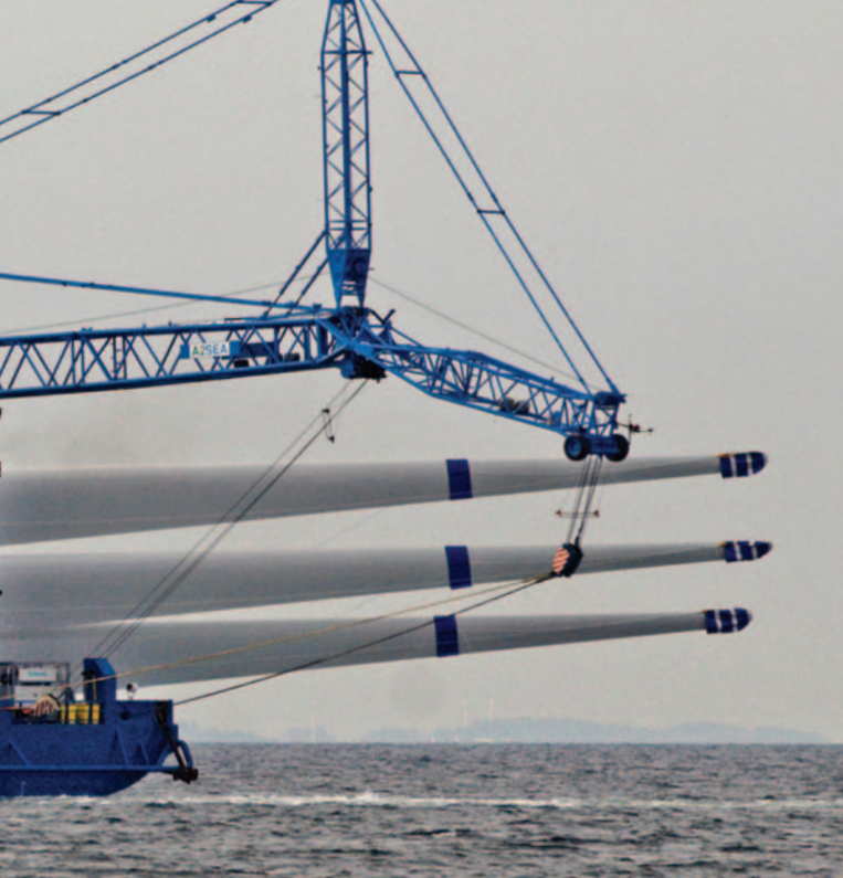
Lillgrund wind farm, Sweden (© Hans Blomberg, Vattenfall)
