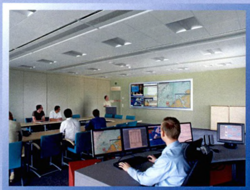
Barco Display Wall systeem voor 24/7 crisis ondersteuning in het MRCC
