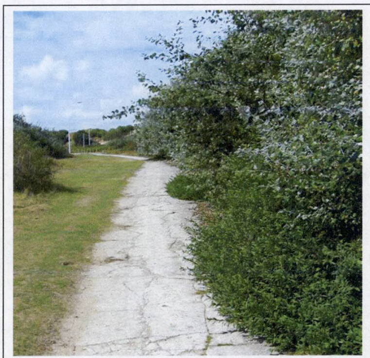
Foto 41. Knelpunt beschadigde verharding asfaltpaden
