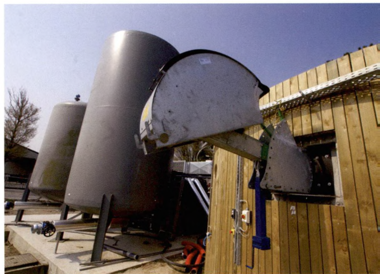
De biogasinstallatie in het POVLT.
