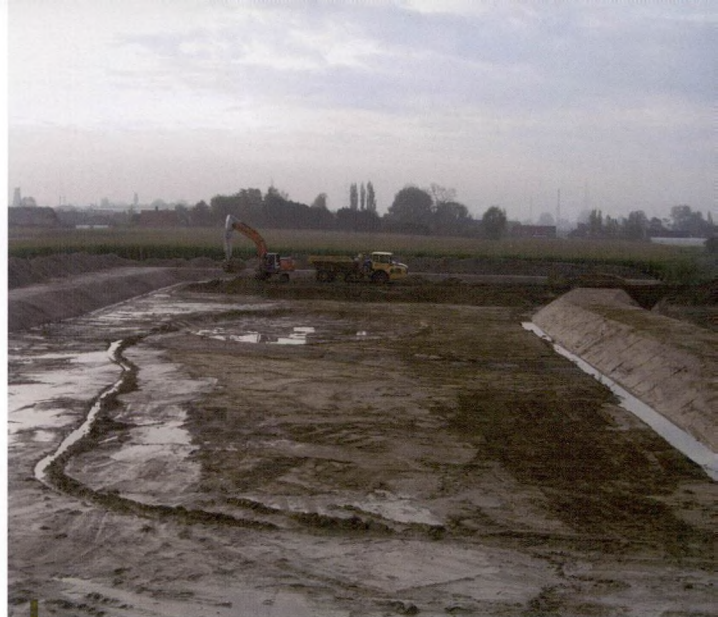
Het bufferbekken langs de Lendelededeek.
