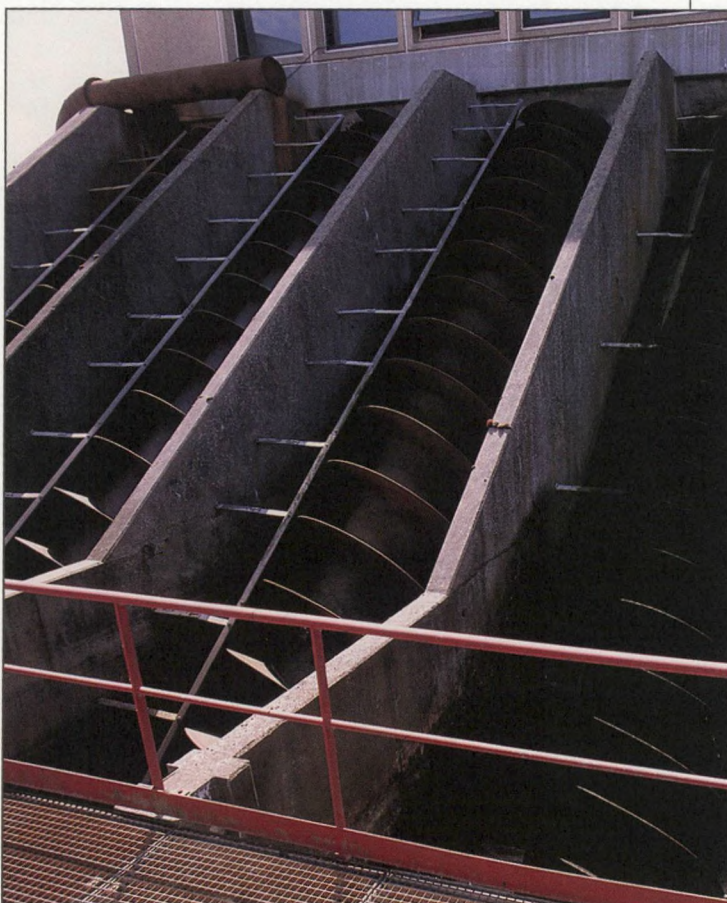
ARCHIMEDES-SCHROEFEN RWZI BRUGGE - BRUGGE
