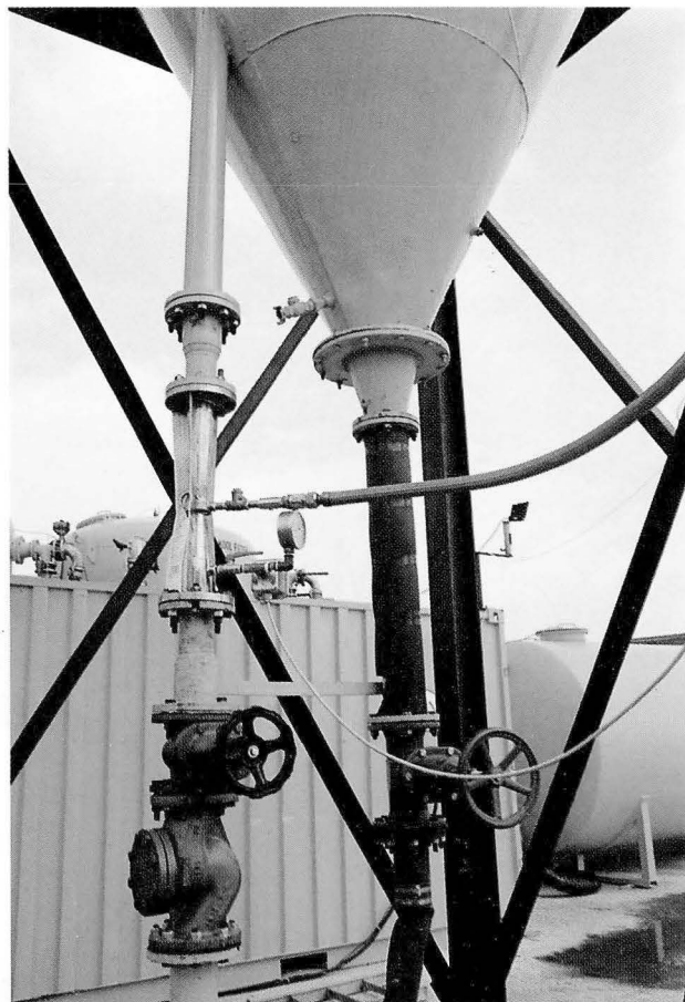
Foto 12. — Waterzuiveringsinstallatie 1e trap: ozonatie.
