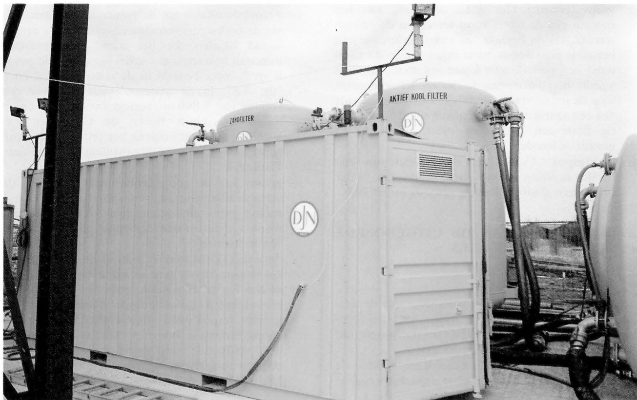
Foto 14. — Waterzuiveringsinstallatie 2e trap filtratie (actieve kool).
