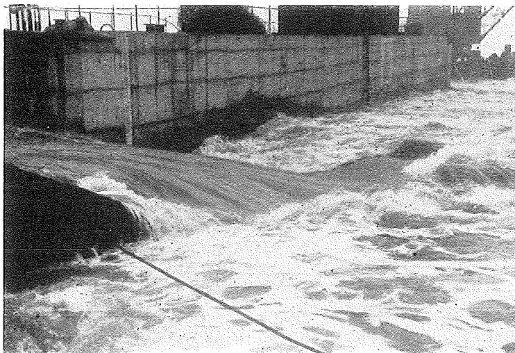
Fig. 134. De op 1 Dec. 1945 geplaatste Phoenix ponton is hevig zij- en onderloopsch.
