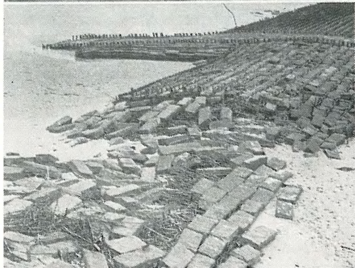
Toujours les destructions causées par la mer.
