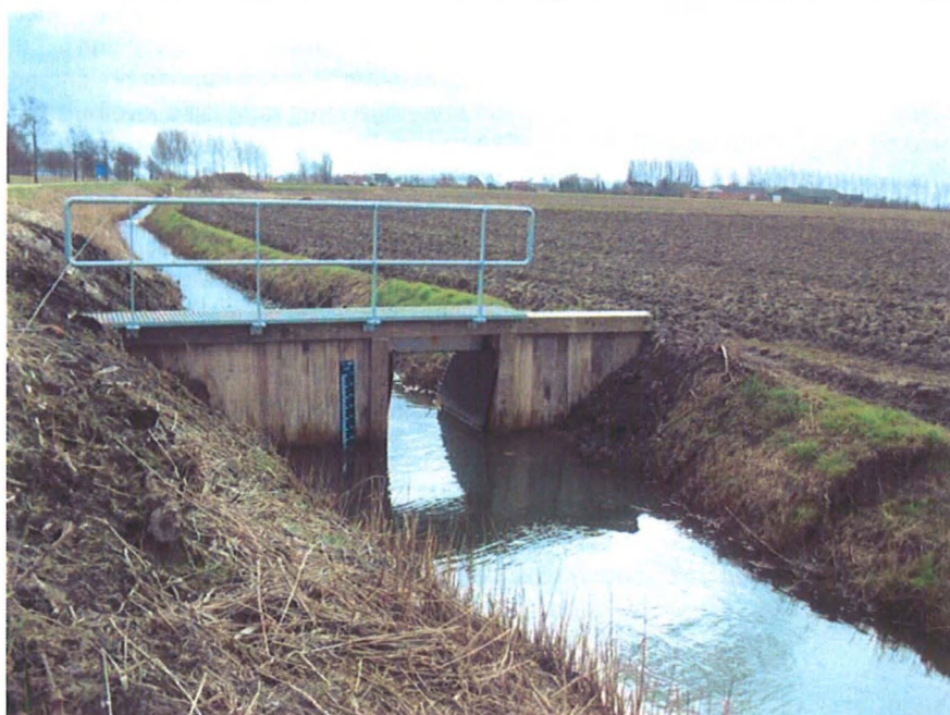
Figuur 6.6. Peilregulerende stuw deel Noordhofpolder
