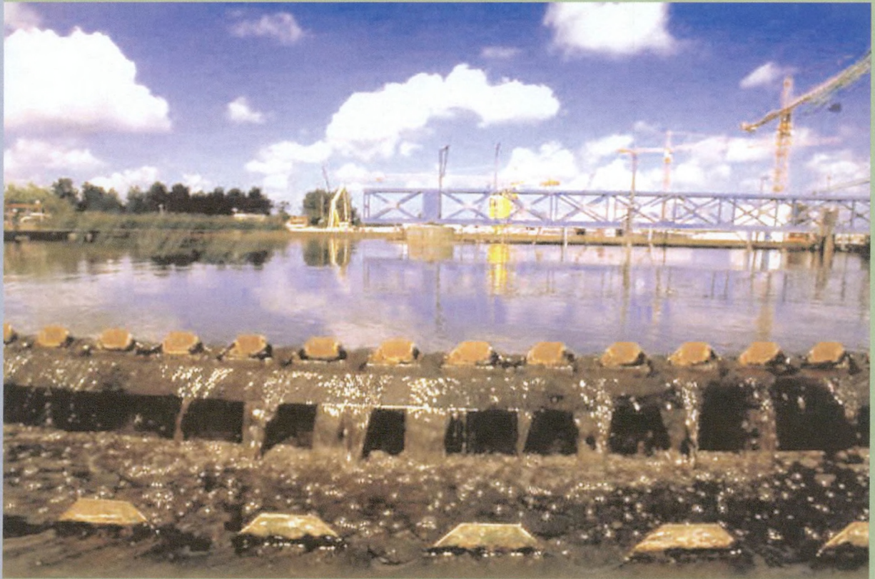
Nabezinktank van de RWZI te Brugge
