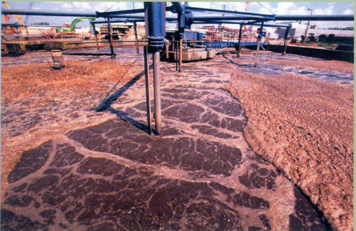
Beluchter van de RWZI te Brugge
