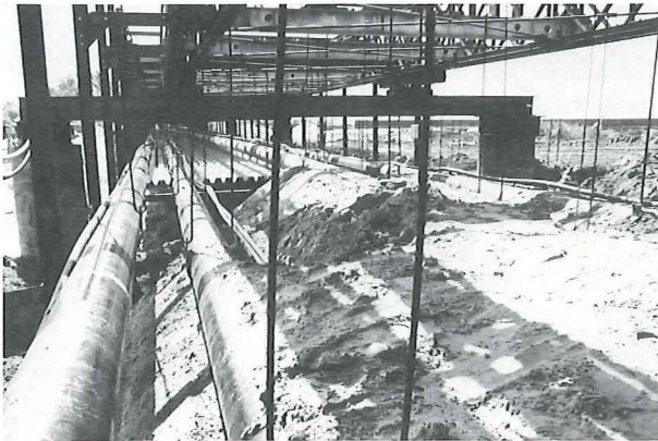
leidingen opgehangen aan Baileybrug
