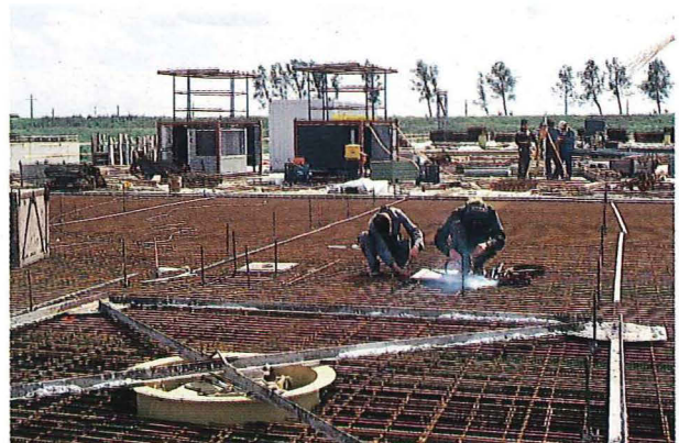
koelunits op tunneldak
