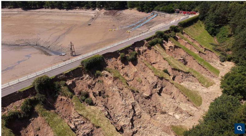
Figuur 8.4: Lege dam bij Steinbach met zichtbare overstromingsschade. (Genearl Anzeiger, 2021. Foto: dpa/David Young)
