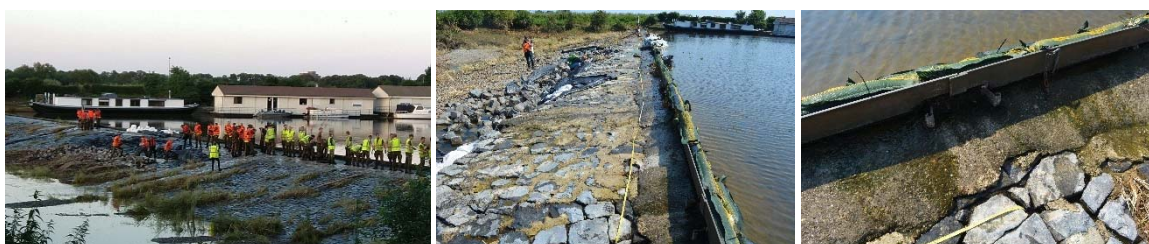
Figuur 4.8: Stuw bij Bosscheveld: noodreparatie met assistentie van het leger (foto Wilbur van Beijnen, Rijkswaterstaat), overzicht kering na reparatie (vloedmerken nog zichtbaar bij de begroeiing op de achtergrond), detail verankering stalen rand.
