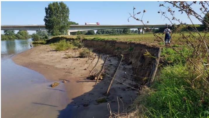
Figuur B.3.4.6: Boxmeer, Zuidereiland (op deze locatie was de erosie voor het hoogwater al aanzienlijk, maar gedurende het hoogwater heeft de erosie verder doorgezet).
