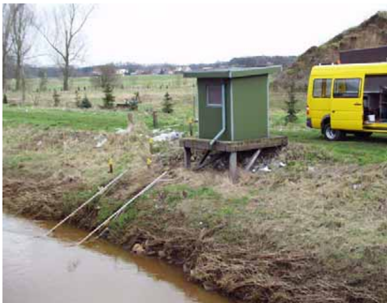
Figuur 5.9: De toestellen van het sedimentmeetnet, zowel de monitor als het staalname-apparaat, werden in de cabine van de Maritieme Schelde geplaatst.
