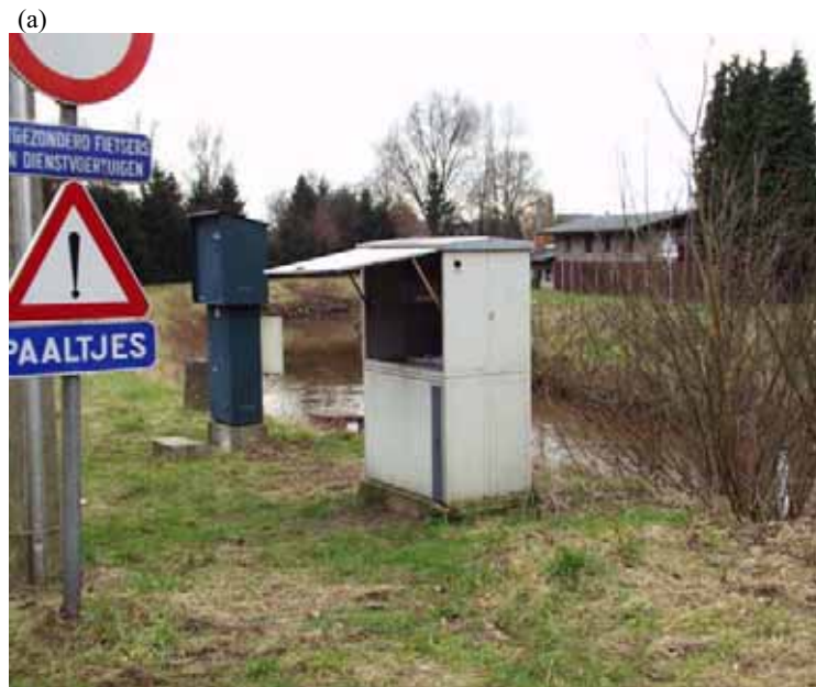
Figuur 5.3: Meetkast te Grobbendonk, rechts van de limnigraafkast (a) waarin in het bovenste deel van de kast de monitor met digitale datalogger bevestigd en in het onderste deel de elektriciteitsmeter met hoofdzekering (b).
