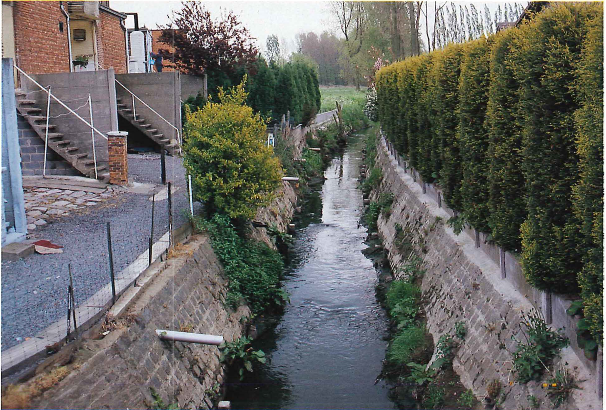
Koestaartbeek (zone 430). Huizen worden vaak tot tegen de beek gebouwd. Ze veroorzaken een versnelde afvoer van het regenwater en verhogen de piekdebieten (pag. 24)
