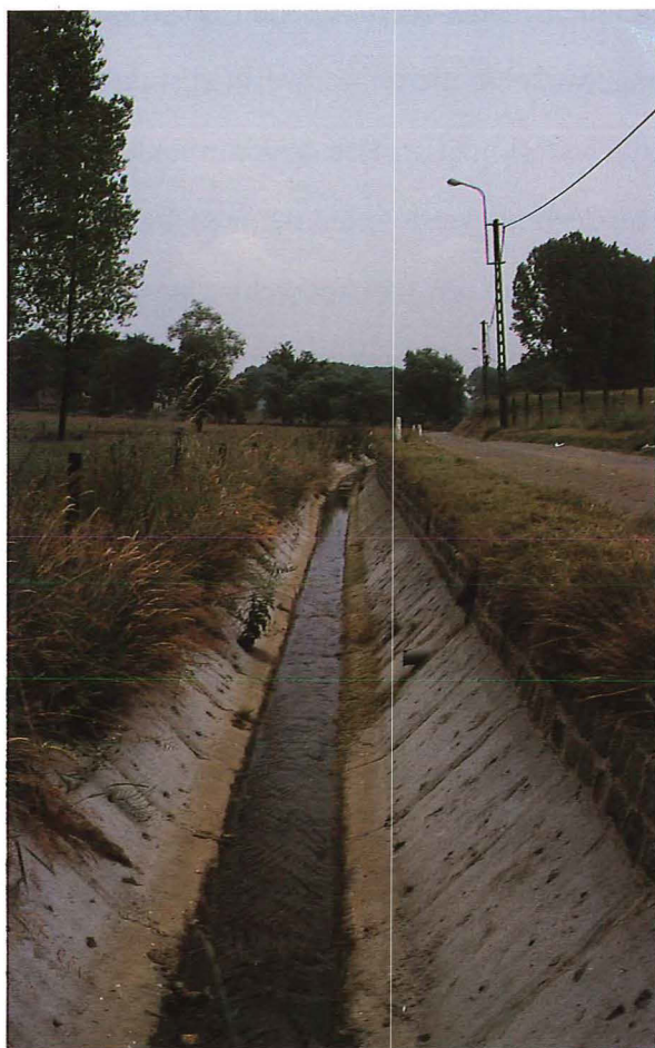
Zijbeek van de Lavondelbeek te Denderwindeke. Een rechtgetrokken beekje met betonnen oeverversteving. Zelfs na een waterzuivering blijven de levenskansen hier gering.
