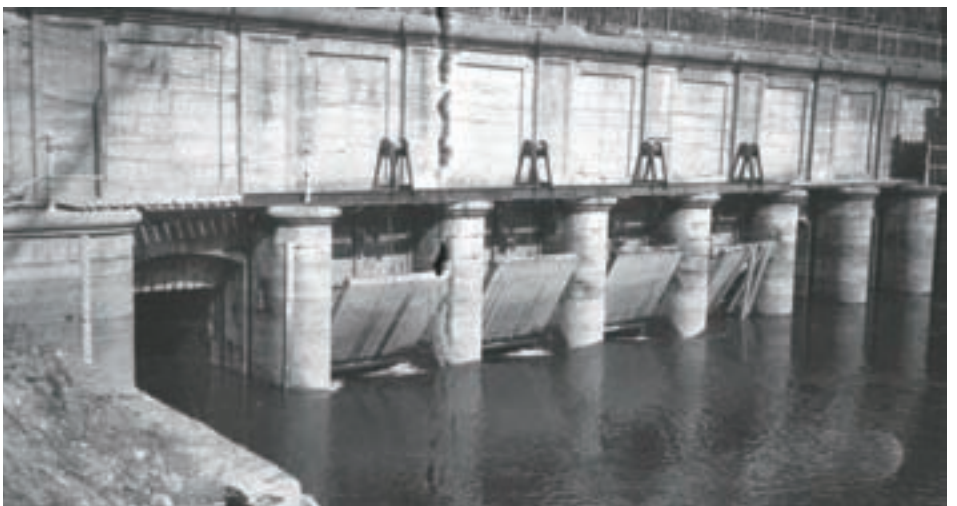
■ De schuiven van de Noordvaart, die bij de tweede poging geopend werden (Kristof Jacobs, Nieuwpoort Sector 1917)
