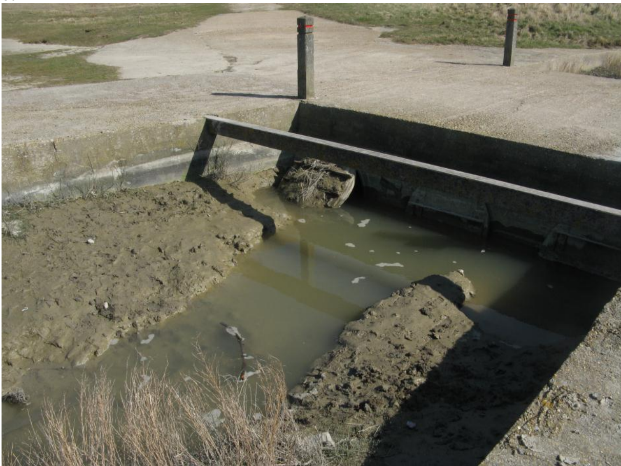
Foto. De ondertussen grotendeels verzande klepsluizenconstructie, aangelegd begin de jaren 1960 en bedoeld om voor langere tijd zout water op te houden in het westelijk deel van het Zwin.
