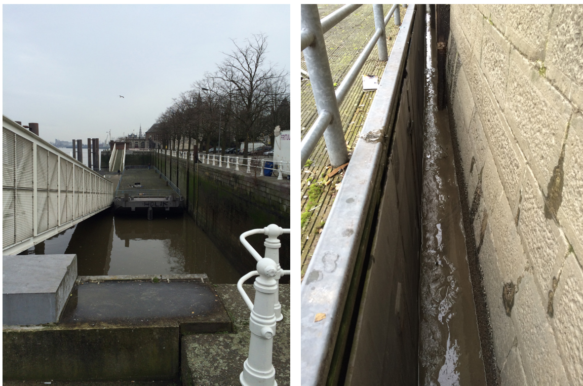
Figuur 2 – Ponton Steenplein (links) en detail droogvallend sediment tussen ponton en kaaimuur (rechts)
