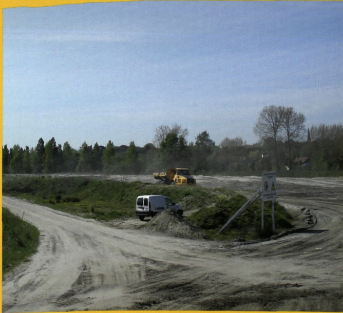
De uitbreiding van het Zwin brengt vooral dijk- en graafwerken met zich mee.
