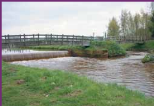
Lokstroom bij visdoorgang Kleine Nete kort onder de stuw (B)
