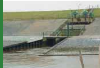
Uitstroom gemaal en lokstroom hevel-vispassage Foto: G. Wintermans
