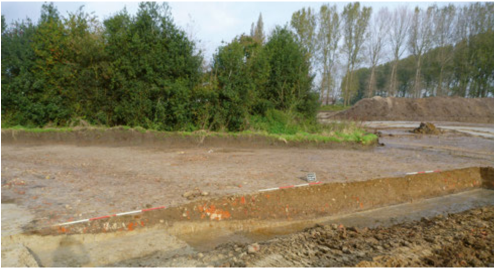
FIG. 8.8 Terreinopname van de machinaal gegraven coupe C-D op walgracht 200057, zicht vanuit het zuiden.
