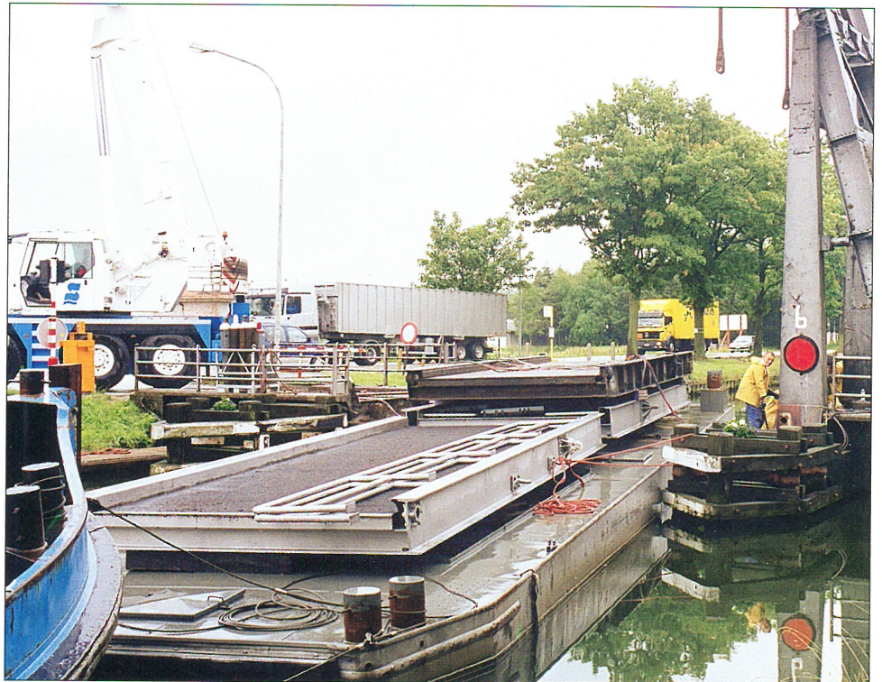
Plaatsen van een nieuw metalen brugval met antislipplaat aan brug te Beerse
