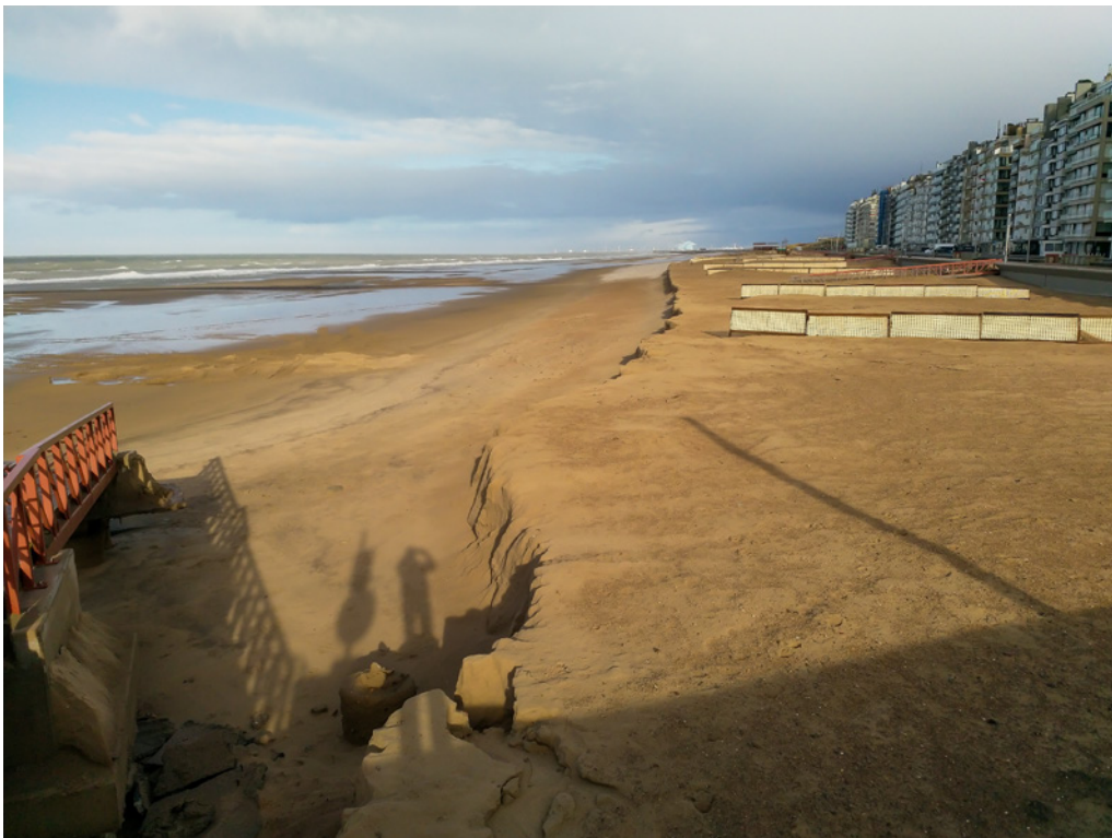
Figuur 4 – Schade aan het strand na de doortocht van storm Ciara
