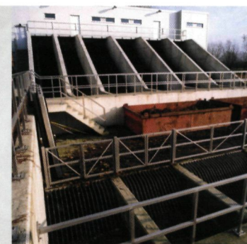
•• Vijzelgemaal op de Ledebeek
