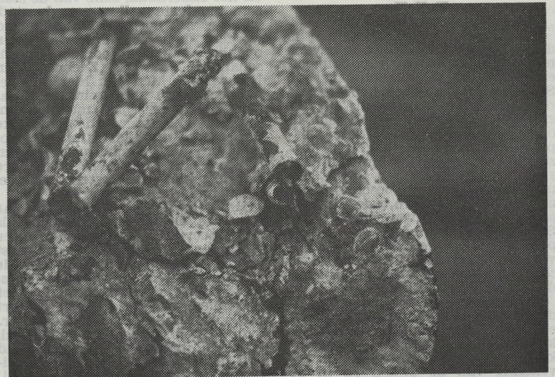
Deze foto duidt duidelijk aan in hoeverre de leuning door ouderdom en het weder ingevreten zijn.
