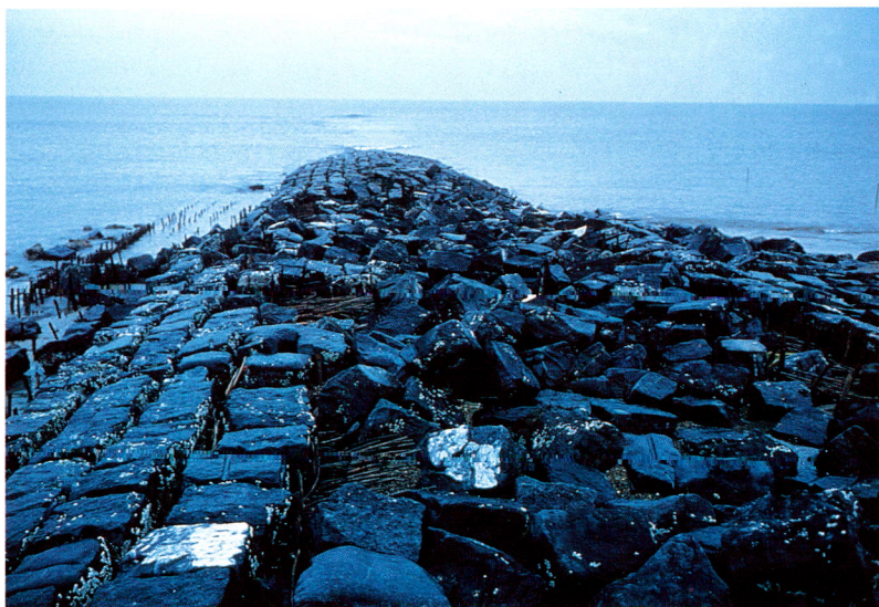
Fig. 4.44 Beschadiging van een strandhoofd na een storm.
