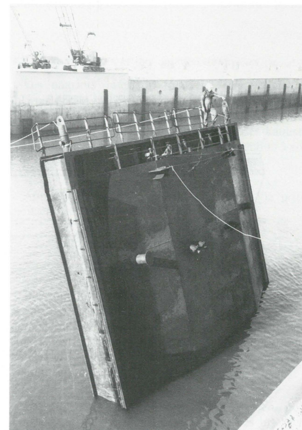
Photo 17. — Écluse de Zeebrugge. Caisson d'obturation d'une chambre de porte pendant la manœuvre de redressement.
