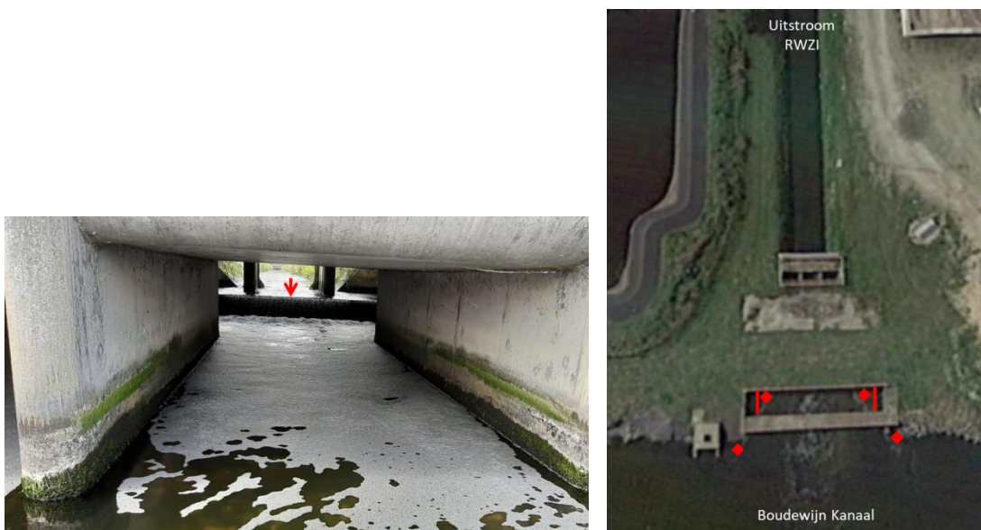
Figuur 32: (links) Uitstroom RWZI Brugge in het Boudewijnkanaal met betonnen stuwtje op de achtergrond (rechts) voorstel positie glasaalgoot (rode lijn) en artificiële substraten (rode ruiten) ter hoogte van de uitstroom RWZI Brugge in het Boudewijnkanaal.
