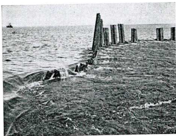
Fig. 13. — Barrage de Mateba. Déformations de la doublure C battue suivant un profil en « peigne » (Février 1937).
