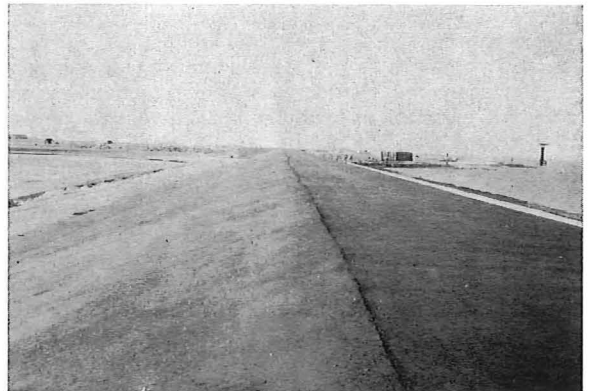
Dijk met asfaltbeton bekleding op het werkeiland Neeltje Jans in de Oosterschelde.
