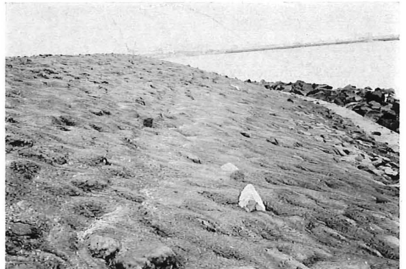
Mastiek penetratie in de haven van Rotterdam. Pénétration au mastic dans le port de Rotterdam.
