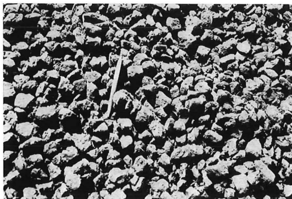
Steenasfalt op het werkeiland Neeltje Jans in de Oosterschelde. Macadam asphaltique mis en œuvre sur « l'île de travail » Neeltje Jans dans l'Escaut Oriental.
