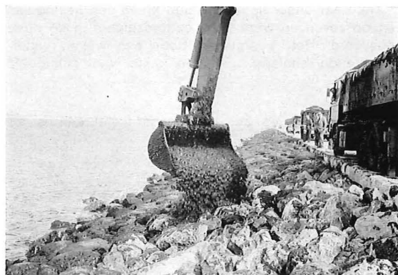
Mastiek penetratie van de Noorderdam in Hoek van Holland. Pénétration au mastic de la « Digue Nord » à Hoek van Holland.
