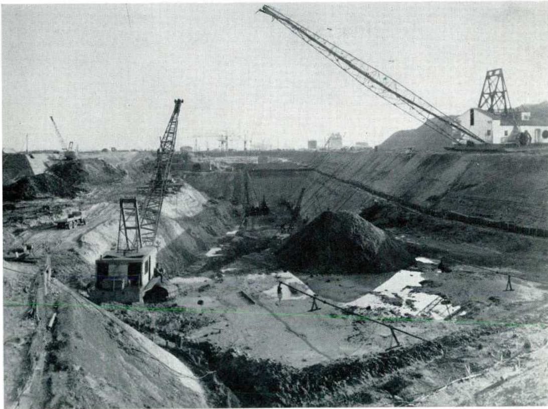
FIG. 31. — LA FOUILLE DE LA TÊTE AVAL (novembre 1952). A l'avant-plan, la dragline Monighan excave directement à profondeur (de +8,00 à -10,50 ). A l'arrière-plan, battage des palplanches au niveau -10,50 .
