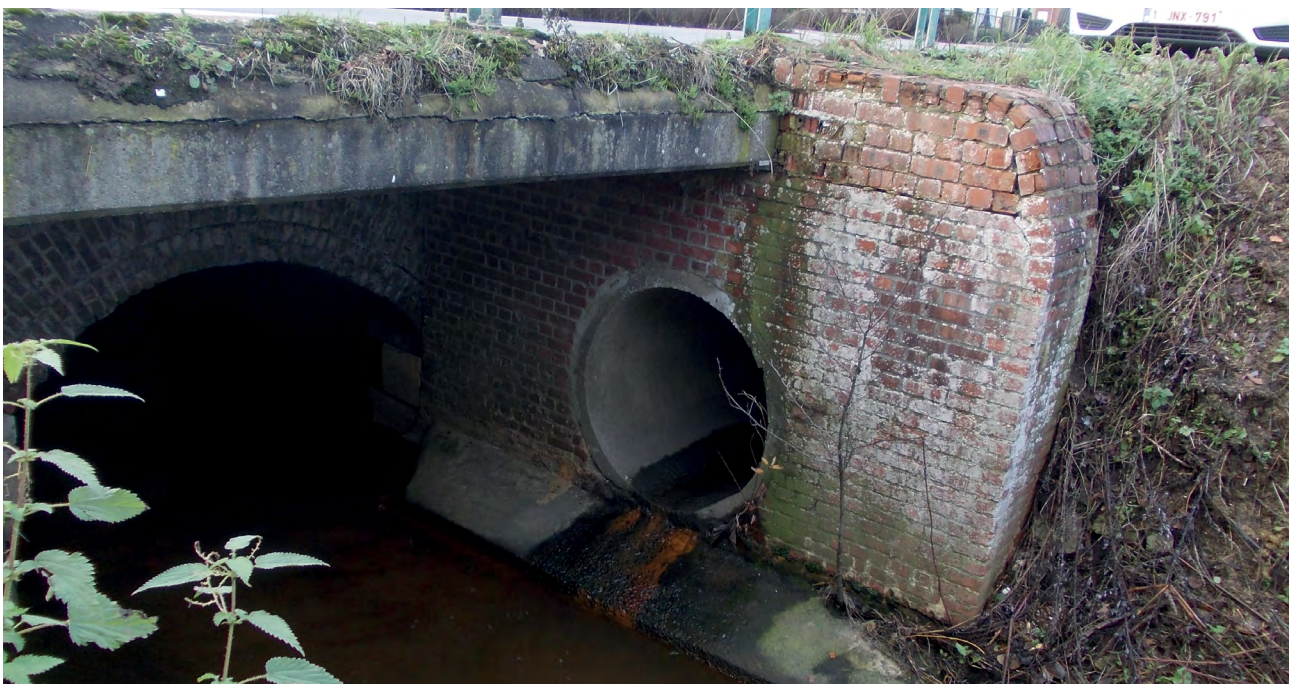
De verharde oppervlakte in Nolimpark draagt sterk bij tot een overbelasting van de gemengde riolering waardoor het overstort in de Houtmolenstraat op de Holvenloop vaak werkt.
