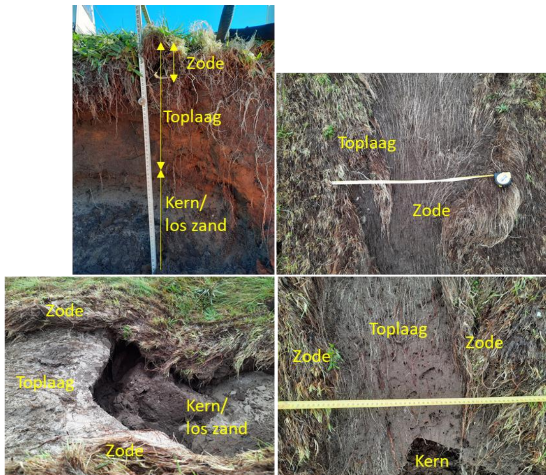
Bijlage Figuur D.2 Illustratie schade en doorbraak van de toplaag op de Vechtdijk, onderscheid tussen zode, toplaag en kernmateriaal (zode is onderdeel van de toplaag). Linksboven: toplaag doorgebroken; rechtsboven: schade; linksonder: toplaag doorgebroken; rechtsonder: toplaag doorgebroken
