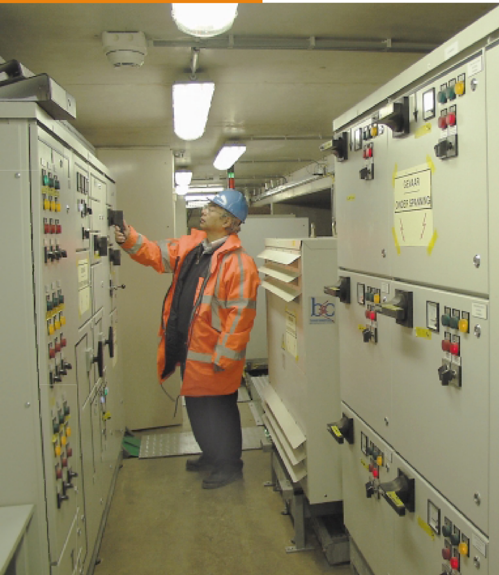
Alleen al vanwege de civieltechnische omvang en innovatieve boormethode is de 6,6 kilometer lange Westerscheldetunnel een kunstwerk van jewelste. Naast het boren, is het hoofdstuk elektrotechnische en mechanische installaties van evenredig belang voor – vooral – het veilig gebruik van de tunnel.
