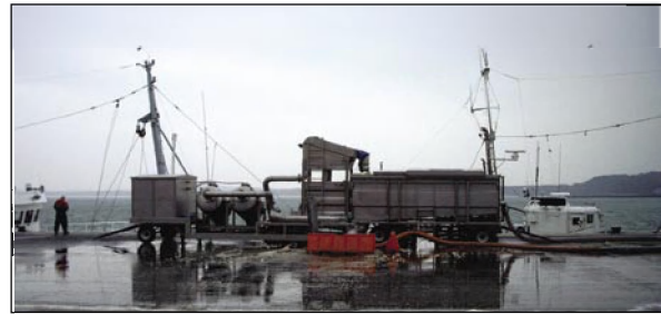
Abbildung 2: Druck-Vakuumanlage mit transportablem Auffangtank und Bodenöffnung zur Unterflurleitung.
