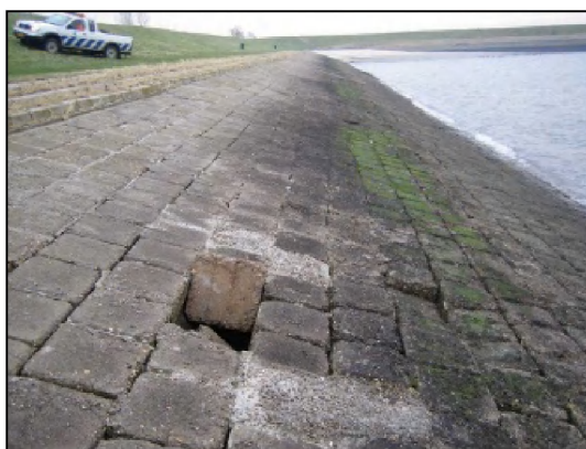
Figuur 5. Voorbeeld van schade (Bron: project zeeweringen, 2007).
