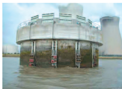
● Om vissen bij de watervang van de kerncentrale te houden werd een afweersysteem geplaatst, gebaseerd op geluid. De boxen (zichtbaar in het rood) worden onder water gelaten en jagen de meeste vissen weg.
