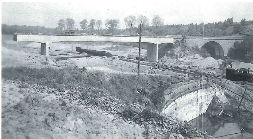
Fig. 41. Gouy-lez-Piéton. Vestiges de l'entrée du souterrain de Bête Refaite. A l'arrière-plan le pont qui franchira le canal à 1.350 t.
