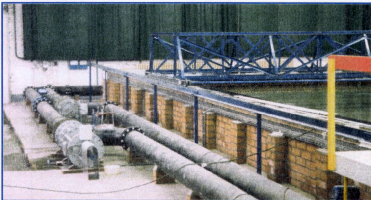
Figuur 16. Detailbeeld van toevoerleidingen en pompen voor langsstroming
