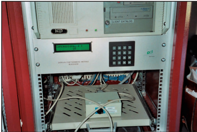
Figuur 11: Black-box: automatisch registreersysteem geïnstalleerd aan boord van alle ontginningsvaartuigen.
