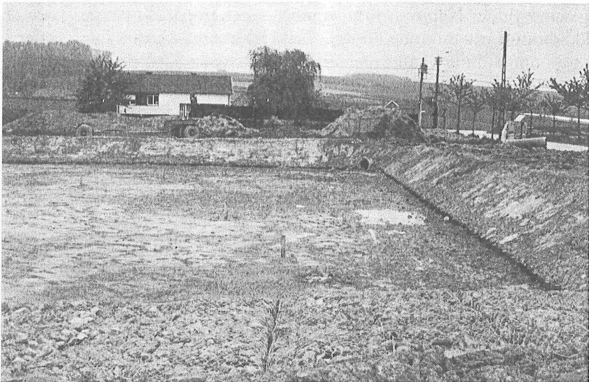
Fig. II. Symptoombestrijding met behulp van een wachtbekken (Leefdaal, mei 1989)
