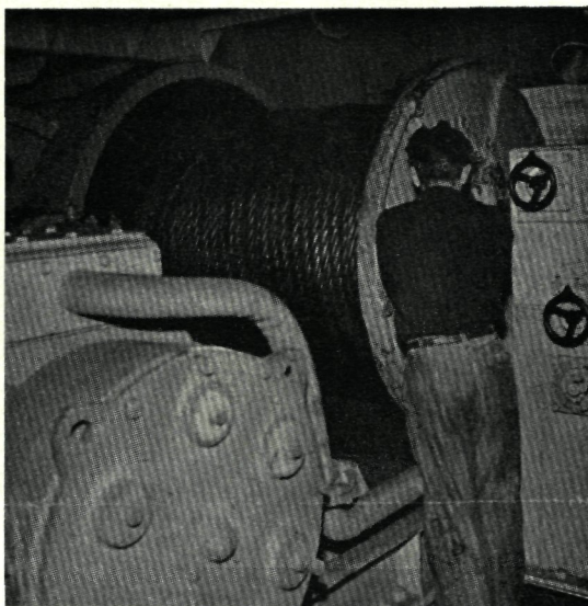
Un des éléments essentiels du remorqueur de haute mer : le treuil sur lequel s'enroule un kilomètre et demi de câble d'acier.
