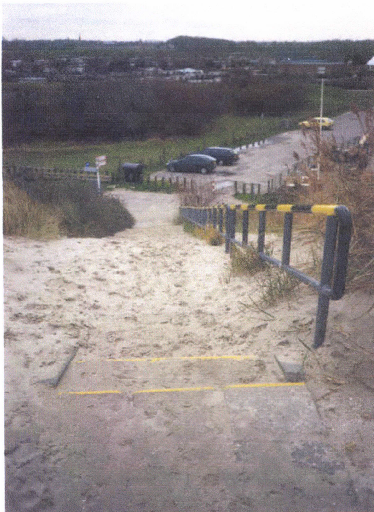
Figuur 4.5. Overlast door over de dijk gestoven suppletiezand
