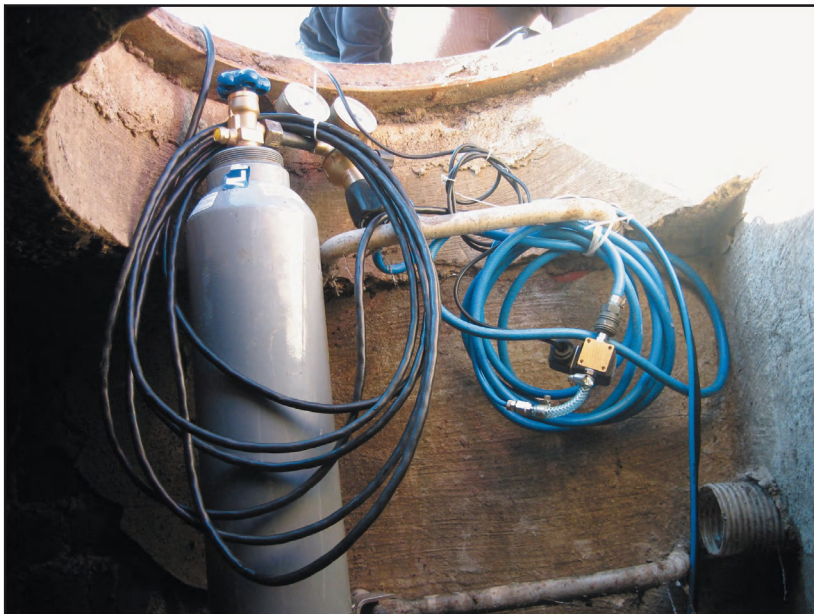
Figuur 5 (a,b): Voorbeeld van een opstelling voor continue waterkwaliteitsmeting in het rioolstelsel
