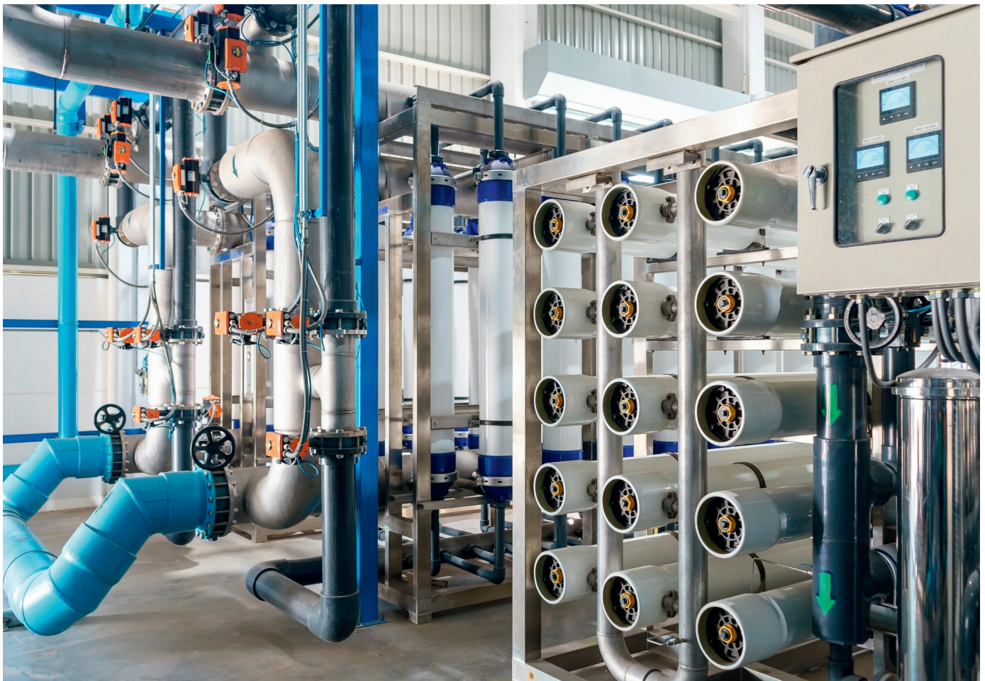
Een ontziltingsinstallatie die het principe van omgekeerde osmose toepast.
