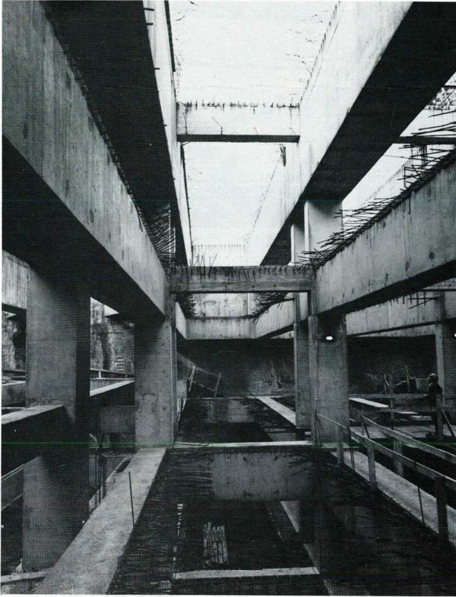
Vue sur la construction en poutres entre le toit et le tunnel lui-même. (15.1.1975) La poutre visible tout au bas de la photo est celle du toit du tunnel routier.
