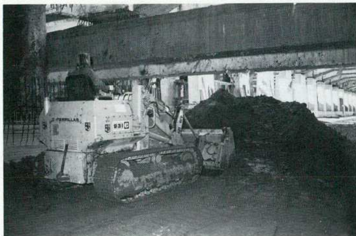
(photo prise le 27 mai 1977) Pour implanter le tunnel in situ, il a fallu déblayer environ 208.000 m 3 de matériaux de natures très diverses et pratiquement imprévisibles. Le volume de béton pour les murs emboués est de l'ordre de 19.300 m 3 .
